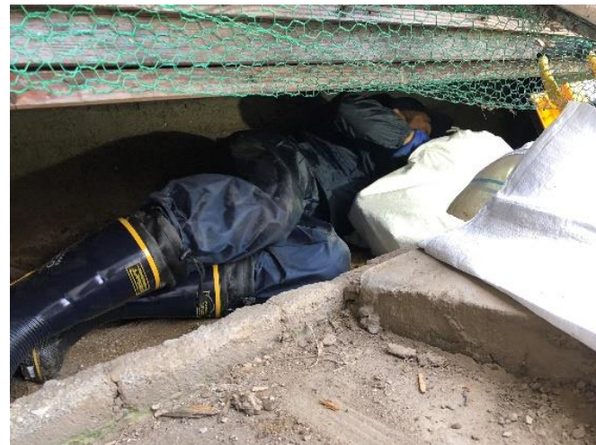
外部からの進入路を確保
